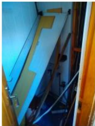
Фото 9. Повреждения внутреннего помещения
