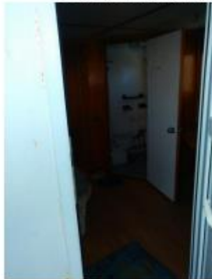
Фото 3. Повреждения внутреннего помещения
