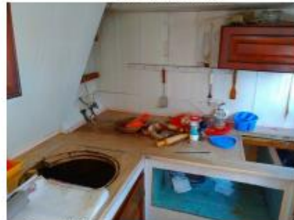
Фото 4. Повреждения внутреннего помещения
