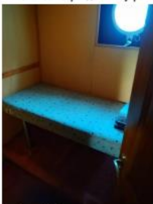
Фото 15. Повреждения внутреннего помещения
