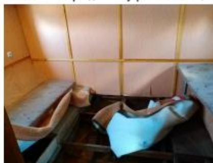
Фото 16. Повреждения внутреннего помещения
