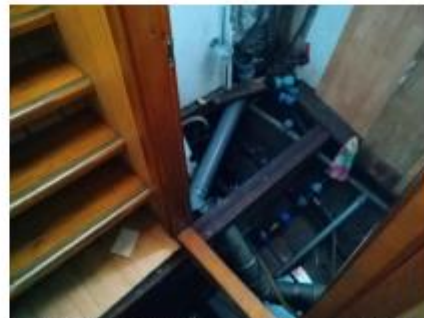
Фото 6. Повреждения внутреннего помещения
