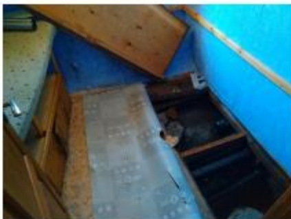
Фото 13. Повреждения внутреннего помещения
