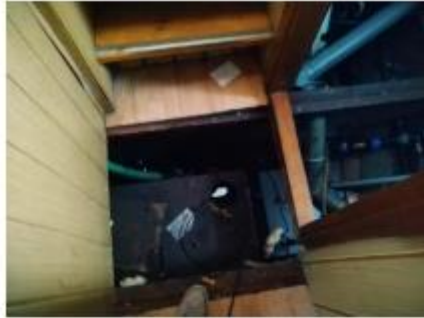
Фото 7. Повреждения внутреннего помещения
