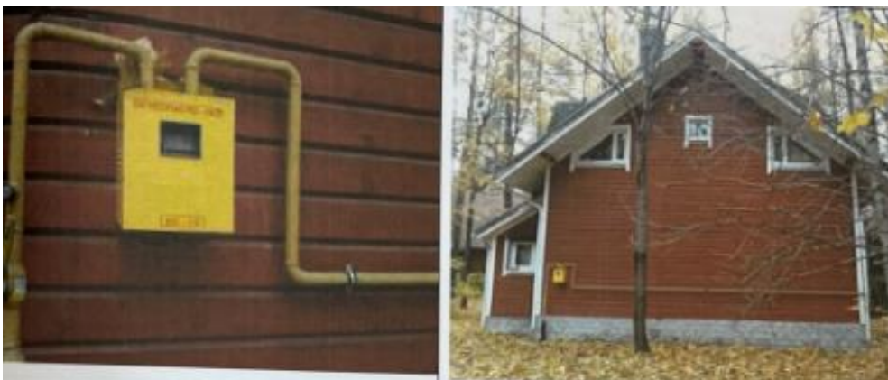
Подвод газа, вид жилого дома
